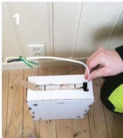
Vi begynner med å rive av papp og gjør klar til å strekke kabel.
